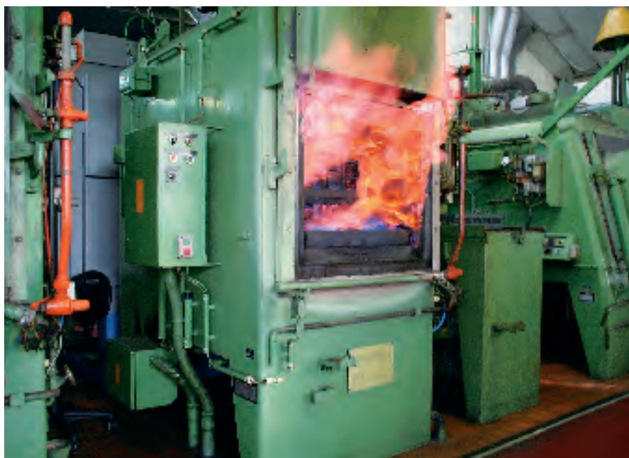
Installation de traitement thermique.
